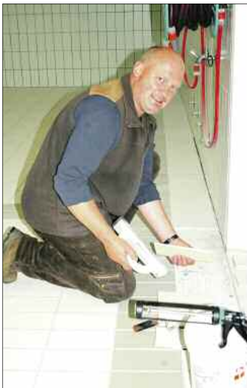
Peter Bäumert, Hausmeister der Sonnenhofschule in Auerbach, bessert während der Schulferien kaputte Fliesen im Badebereich aus.
