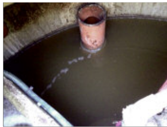
Die verschmutzte und verschlammte Nachklärung der Billiganlage.
