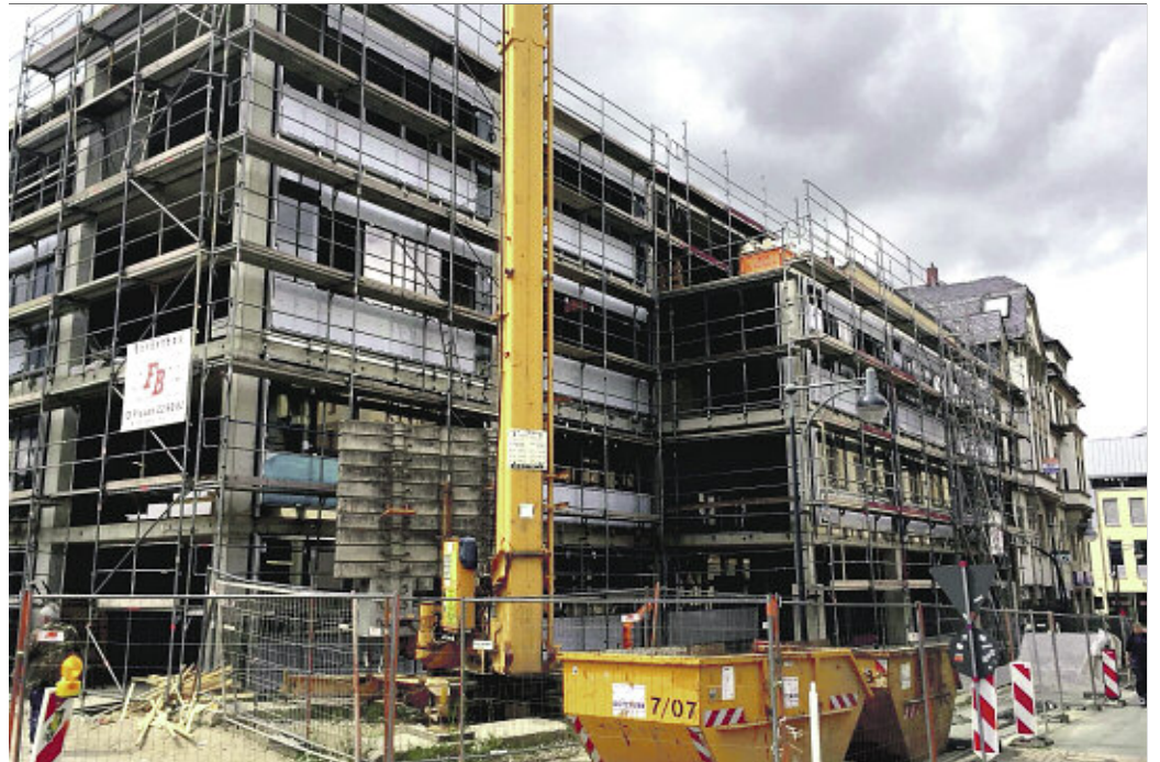
Am Neubau Forststraße geht es indes weiter mit den Arbeiten an der Metallfassade, mit Trockenbauarbeiten im 1. und 2. OG und der Heizung-, Sanitärinstallation. In den anderen Bauteilen (1 bis 3) wird ebenfalls in allen Ebenen tatkräftig gearbeitet.
